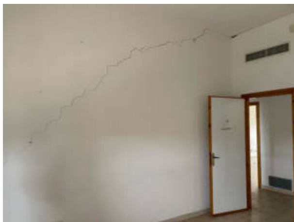
Fotografia 7 Particolare fessurazioni P Primo
