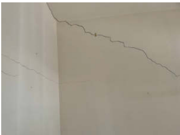
Fotografia 6 Particolare fessurazioni P Primo
