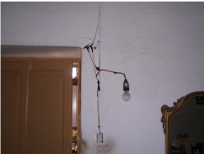
Figura 8 – particolare impianto elettrico esistente
