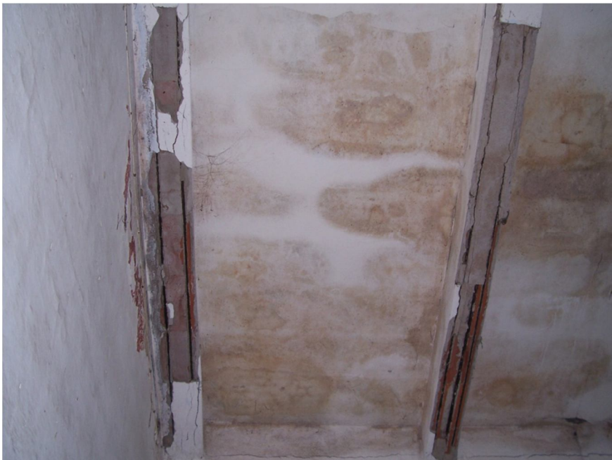
Figura 6 – lesioni strutturali solaio di copertura
