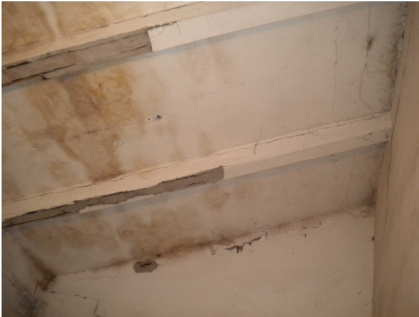
Figura 5 – lesioni strutturali solaio di copertura
