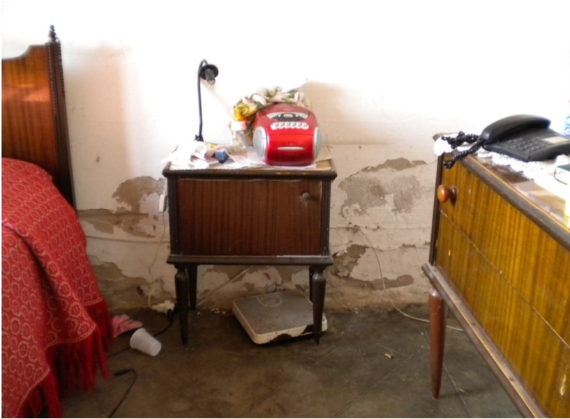
Figura 7 – risalita umidità su pareti interne
