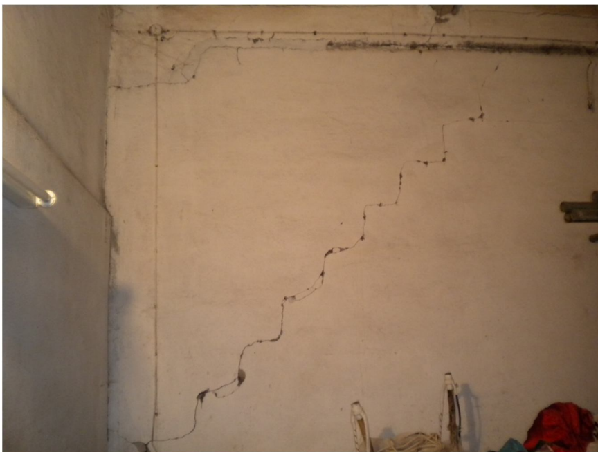
Figura 3 – lesione strutturale muro portante stanza 4
