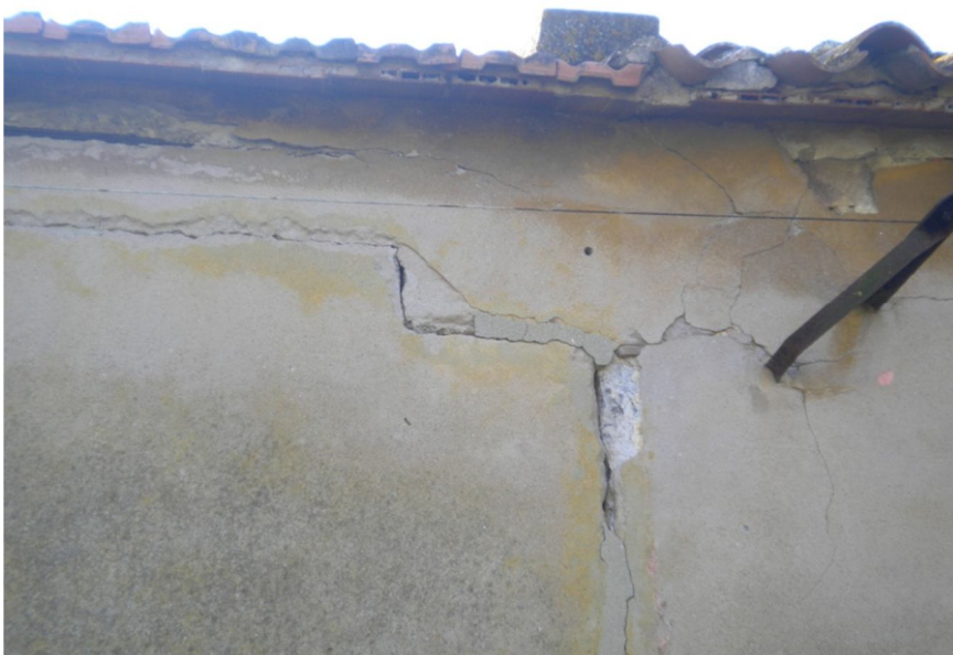
Figura 4 – lesione strutturale muro portante stanza 4 (veduta esterna)
